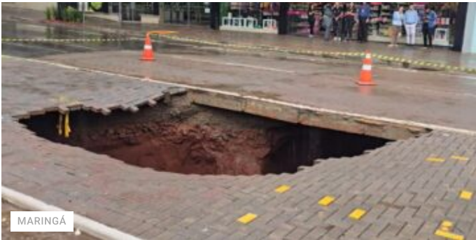
Nova cratera se abre no Novo Centro de Maringá, próximo ao rebaixamento da linha férrea 13 de outubro de 2025
